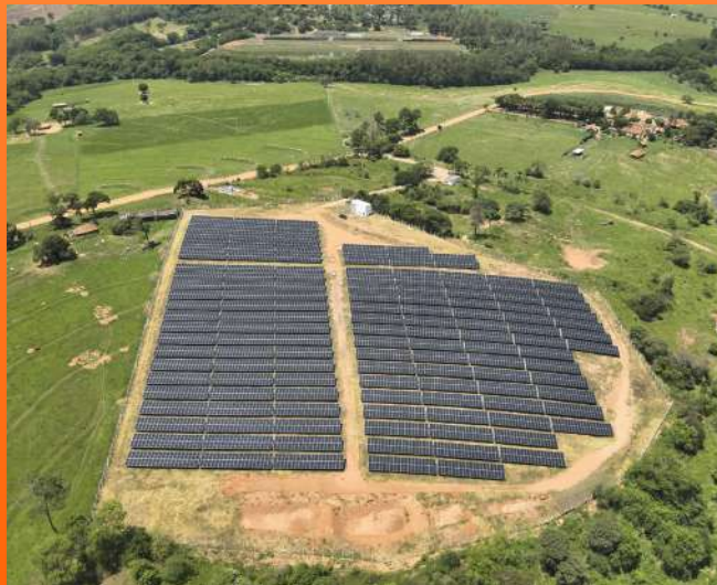
Usina Fotovoltaica Adamantina (Sabesp)
