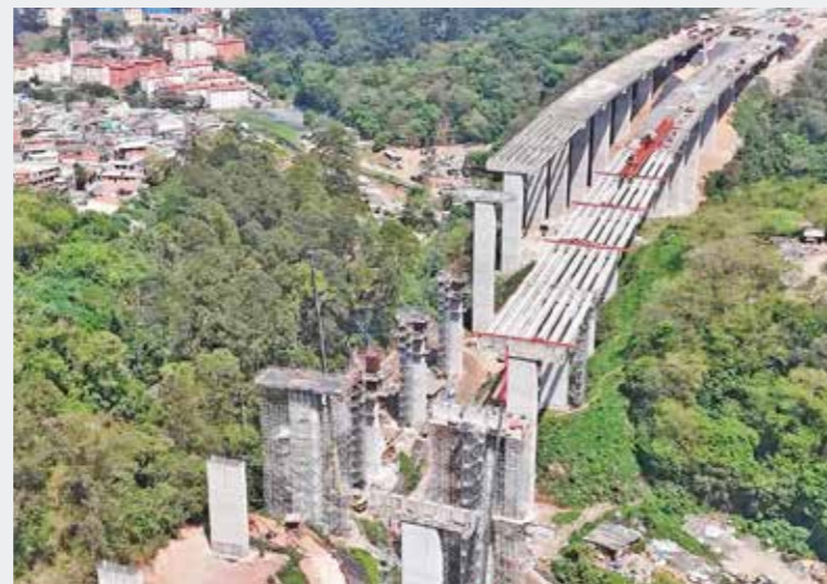
Rodoanel Mário Covas Trecho Norte – Lançamento das Vigas Pré-Moldadas da OAE 109 – Estaca 1290
