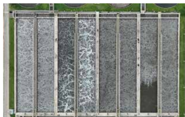
Tanque de aeração
